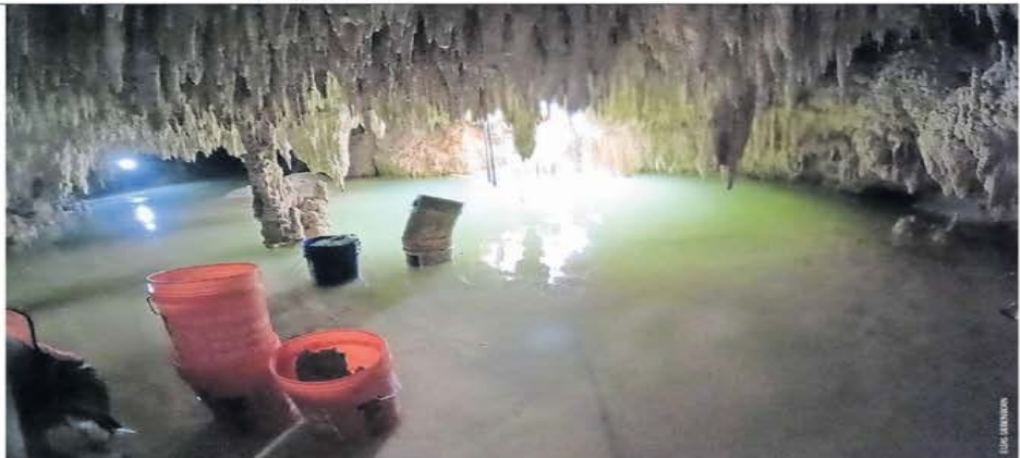
En el informe se detalla que al colocar los pilotes hubo afectaciones en las cavernas sobre las que corre el Tramo 5 Sur, como la caída de cemento en el agua.
