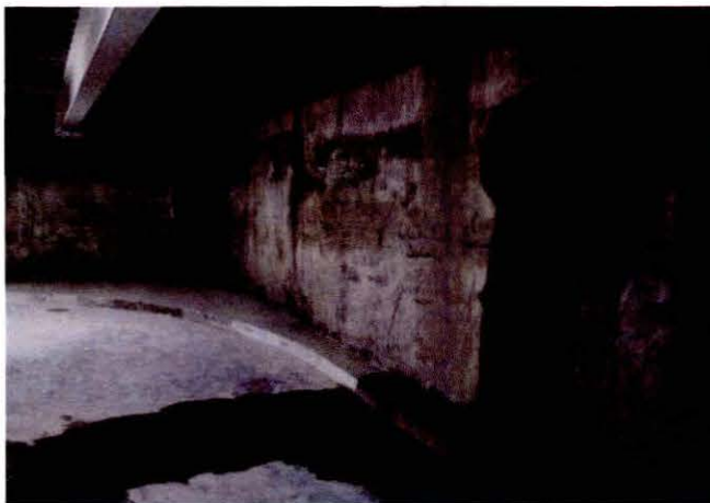
Muro perimetral con filtraciones (sótano 01)
