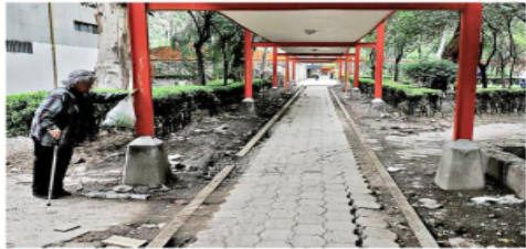
Corredores en mal estado y jardineras descuidadas evidencian el deterioro de la unidad habitacional.
