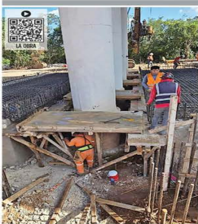
Trabajos de apuntalamiento intentan frenar el hundimiento de pilotes del Tren Maya.
