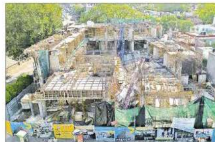
◀ Cuatro trabajadores fueron hospitalizados luego de que una grúa telescópica de 40 metros colapsó dentro de un edificio en construcción en Viaducto Miguel Alemán y avenida Cuauhtémoc, mientras 173 personas fueron desalojadas. El aparato recibía mantenimiento cuando sucedió el percance y el operador se encuentra entre los lesionados. Foto Cuartoscuro J. QUINTERO Y K. RUIZ / P 24
